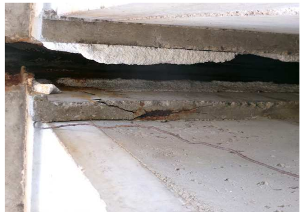
S6 바닥판하면 파손 및 철근노출
