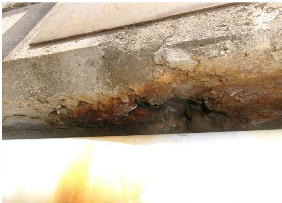
S4 바닥판하면 파손 및 철근노출
