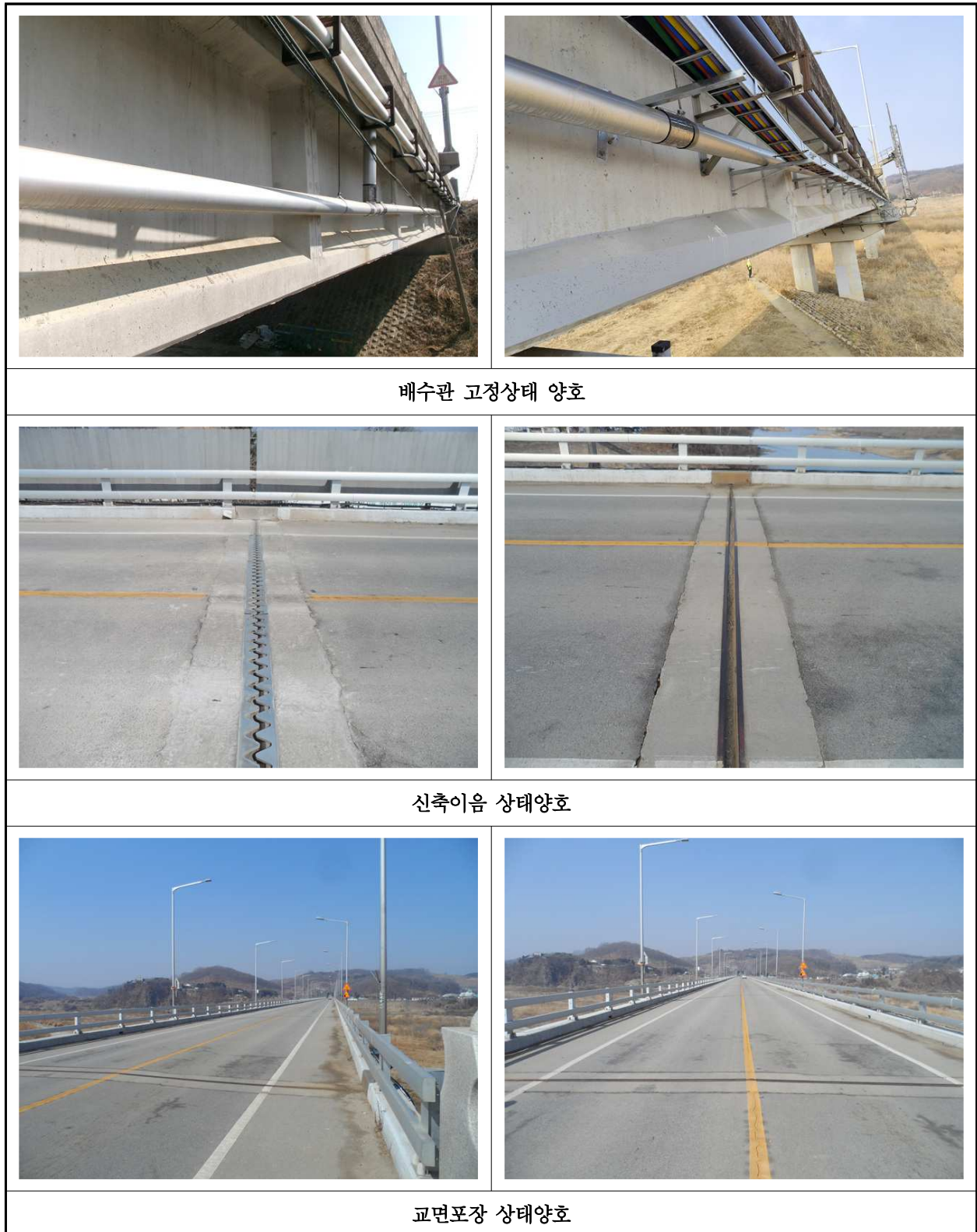
【사진 3.33】 교량의 공중이용시설 10대 위험요소 손상현황(계속)
