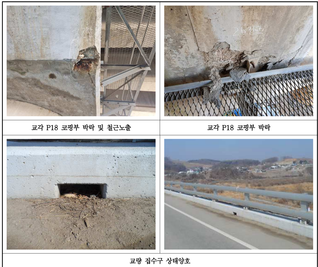
【사진 3.33】 교량의 공중이용시설 10대 위험요소 손상현황
